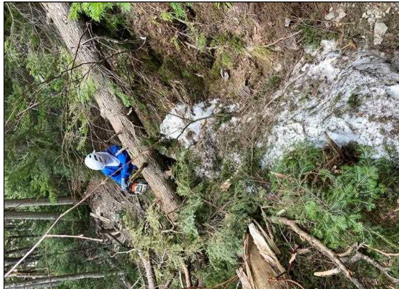
倒木除去作業中
