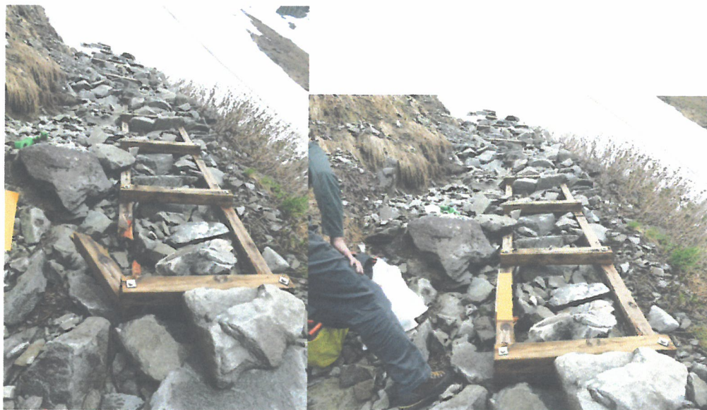
南稜鎖場下、北穂沢土砂崩れ整備 (6/25)
